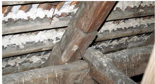
Ryc. 6. Niewłaściwe połączenie w miejscu sztukowania krokwi na płatwi Fig. 6. Incorrect joining in the place where rafter was lengthened on the purlin
