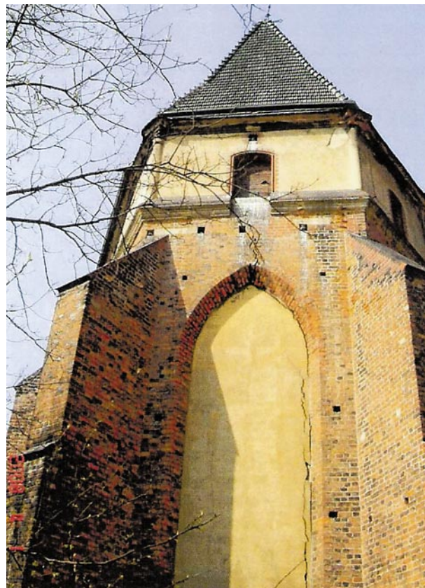
Ryc. 17. Ściana wschodnia prezbiterium – górna i środkowa partia ściany. Pionowe pęknięcie biegnące przez całą wysokość ściany. Pęknięcie wydziela blendę otworu okiennego Fig. 17. East wall of the presbytery – upper and middle part of the wall. A vertical crack running the whole height of the wall. The crack highlights the blind window opening
