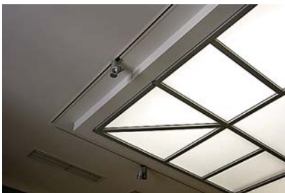
Ryc. 4. Fragment sufitu świetlnego z paneli poliwęglanowych Fig. 4. Fragment of a luminous ceiling from polycarbonate panels
