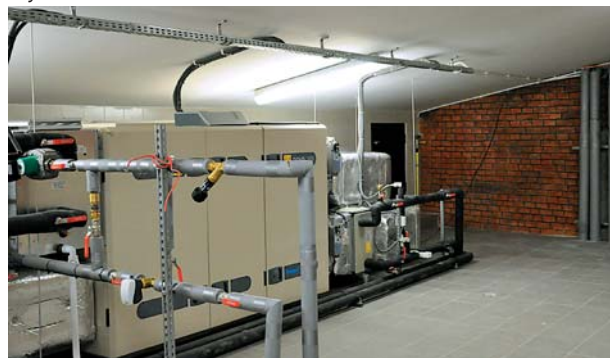
Ryc. 20. Wnętrze nowej centrali wentylacyjnej i klimatyzacyjnej Fig. 20. Interior of the new ventilation and air-conditioning control-room
