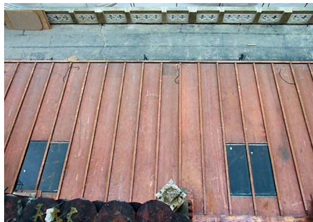
Ryc. 16. Widok dachu pulpitowego z oknami pościowymi antyrefleksyjnymi w płaszczyźnie pokrycia (w trakcie budowy) Fig. 16. View of the pitched roof with anti-reflective windows flush with the roof plane (during construction)
