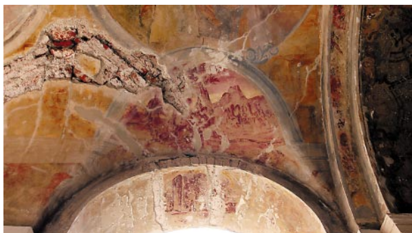
Ryc. 5. Uszkodzone sklepienie sanktuarium w Świętej Lipce (zdjęcie: Szymon Konecko z Pracowni Konserwacji Zabytków STIUK w Olsztynie) Fig. 5. Damaged vault of the Sanctuary in Święta Lipka (photo: Szymon Konecko from the Monument Conservation Laboratory STIUK in Olsztyn)
