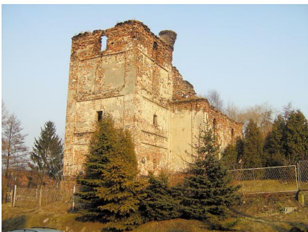
Ryc. 2. Ziemięcice, kościół pw. św. Jadwigi – w ruinie (zdjęcie: autor) Fig. 2. Ziemięcice, the church of St. Hedwig – ruined (photo: author)
