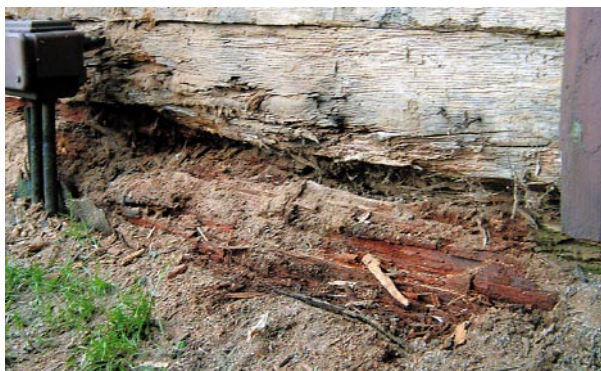
Ryc. 9. Przykład uszkodzonej belki podwalinowej w kościółku pw. św. Rocha w Radomsku (zdjęcie: autor) Fig.9. An example of a damaged ground beam in the church of St. Roch in Radomsko (photo: author)
