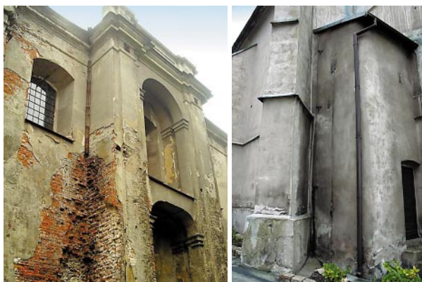
Ryc. 6. Przykłady negatywnego wpływu wód opadowych na sakralne obiekty zabytkowe: a) kościół w Bolszowcach [2]; b) kościół pw. św. Trójcy w Będzinie (zdjęcie: Jerzy Bochen) Fig. 6. Examples of negative impact of precipitation on historical church objects: a) the church in Bolszowce – [2]; b) the church of the Holy Trinity in Będzin (photo: Jerzy Bochen)
