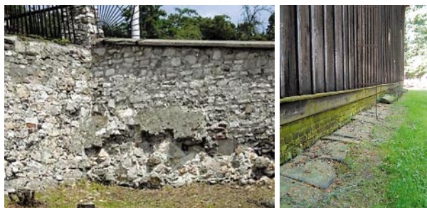
Ryc. 13. Przykłady uszkodzeń z powodu niewłaściwego użytkowania: a) mur ogrodzeniowy kościoła pw. Trójcy Świętej w Będzinie; b) otoczenie kościółka pw. św. Marcina w Ćwiklicach (zdjęcia: autor) Fig.13. Examples of damage caused by improper use: a) the fence wall of the Holy Trinity Church in Będzin; b) surroundings of the St. Martin Church in Ćwiklice (photos: author)
