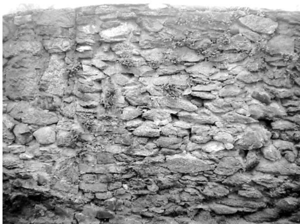
Ryc. 2. Uszkodzenia spoin muru obwodowego Niemczy, woj. dolnośląskie, spowodowane rozwojem roślinności (fot. W. Misztal) Fig 2. Damage to joints in perimeter wall of Niemcza (Lower Silesian Province) caused by growth of vegetation (photo by W. Misztal)
