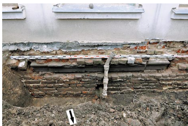
Ryc. 10. Lublin, klasztor powizytkowski, kościół, fasada północna. Wykop 6/10, część środkowa. Lico północne muru fundamentowego fasady północnej z zachowanym piaskowcowym progiem kościoła Wizytek. Nad progiem widoczne przemurowania związane z likwidacją otworu wejściowego, widok na S. Fot. R. Solski, 11.08.2010 r.
