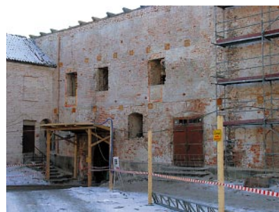
Ryc. 11. Południowy odcinek elewacji wschodniej (dziedzińcowej) skrzydła zachodniego (faza II) po skuciu tynków. Na piętrze ślady po otworach drzwiowych, poniżej i powyżej nich gniazda po belkach drewnianego krużganka lub ganku (niekiedy z pozostałościami belek). W zwieńczeniu elewacji mur pełny zakończony rolką (w ramach remontu zostały w nim wykute od podstaw otwory okienne). W dole ślady po pierwotnych otworach drzwiowych (zamkniętych ostrołukowo) oraz okiennych (zamkniętych odcinkiem łuku), a także otwór bramny z fazy IV. Fot. L. Wawrykiewicz, 2010
