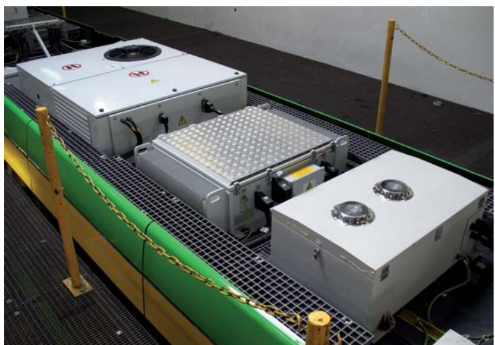
Aparatura dachowa na II członie wagonu, z dominującym kontenerem klimatyzatora
