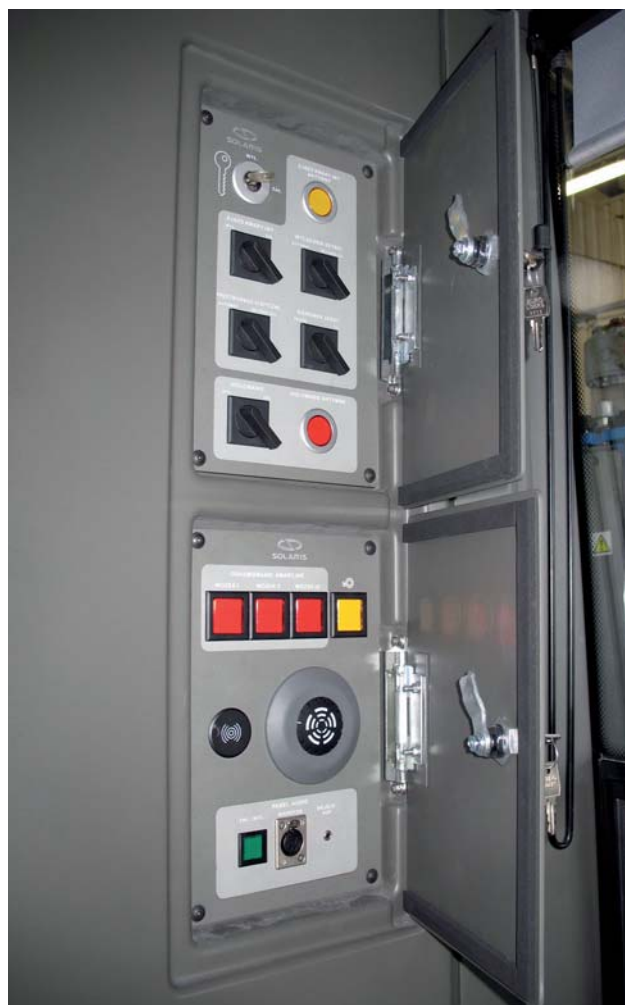
Pulpity umieszczone w tylnej szafce kabiny sterowniczej zawierają przełączniki awaryjnych trybów pracy oraz panel audio
