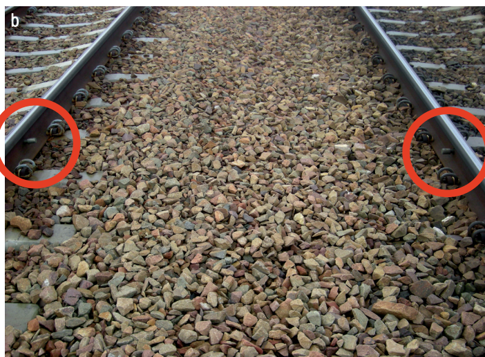
Fot. 1. Pozostałość po skradzionym łączniku a – międzytorowym, b – międzytorowym (połączenia kółkowe)
