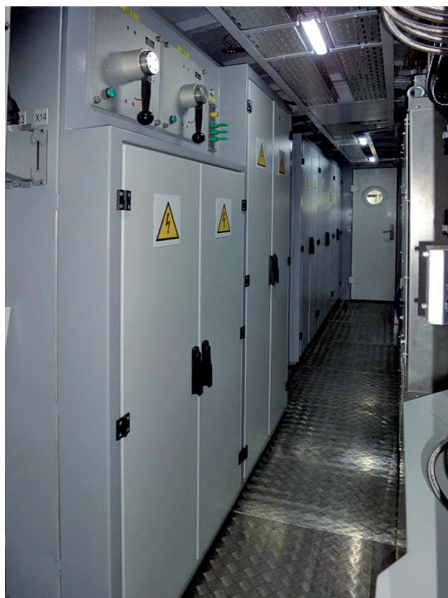
Fot. 2. Przedział maszynowy - widok od strony kabiny 2
