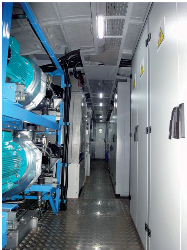
Fot. 1. Przedział maszynowy - widok od strony kabiny 1
