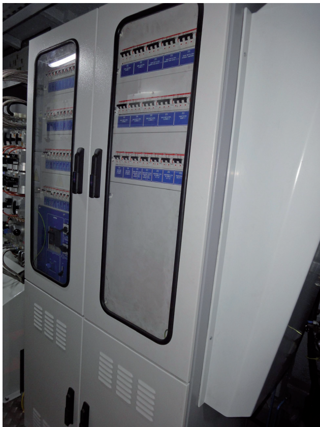
Fot. 5. Szafa NN
