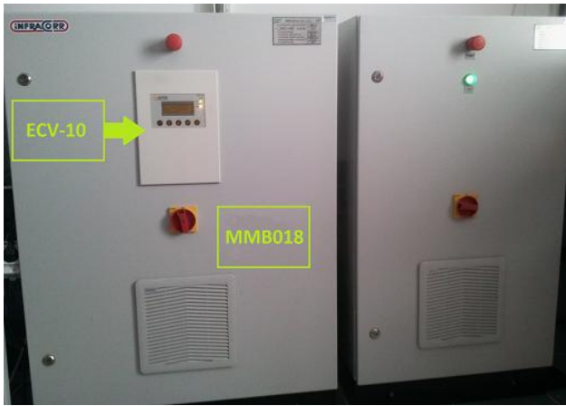
Rys. 4. Część elektryczna stanowiska z przekształtnikiem sieciowym kogeneratora MMB018 i systemem ECV-10
