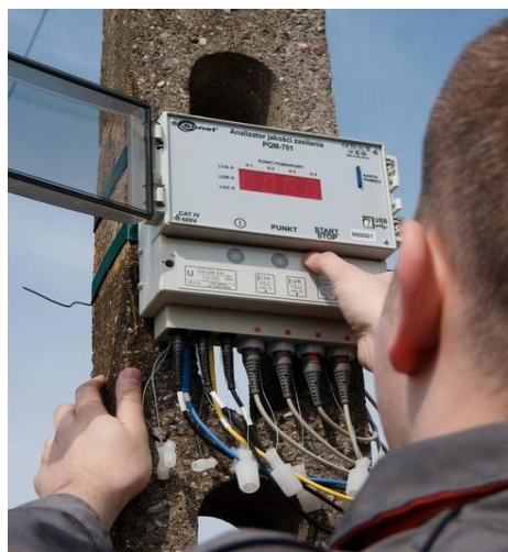
Rys. 9. Fotografia analizatora PQM-701 w miejscu zainstalowania
