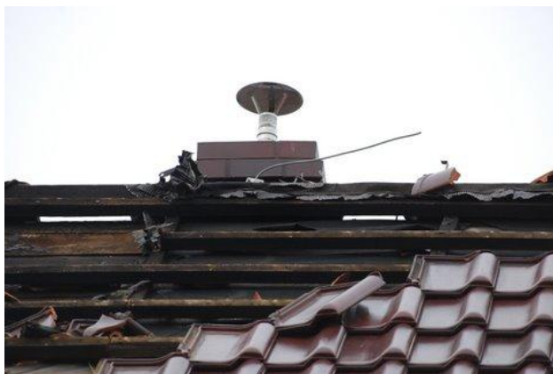
Rys. 7. Szkody wywołane w budynku bezpośrednio uderzonego piorunem. Widoczna nieprawidłowa ochrona wsadu ze stali kwasoodpornej za pomocą zwodu pionowego – brak zachowania kątów ochronnych
