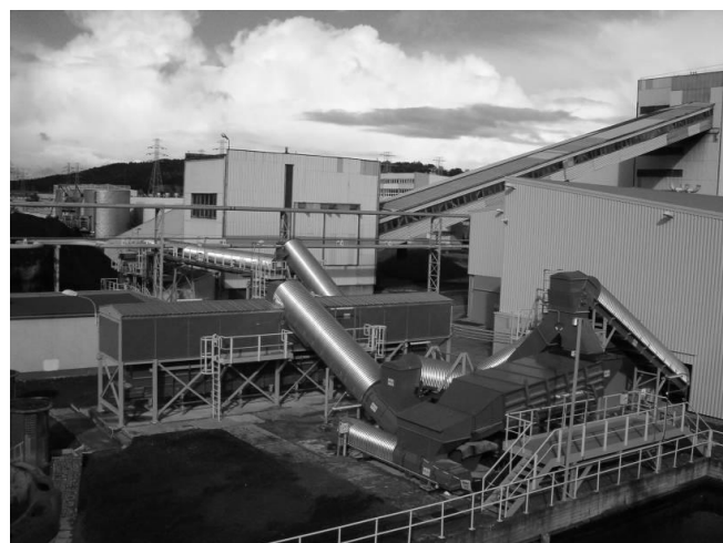
Rys. 4. Instalacja do współspalania biomasy z węglem w Elektrociepłowni Gdyńskiej
