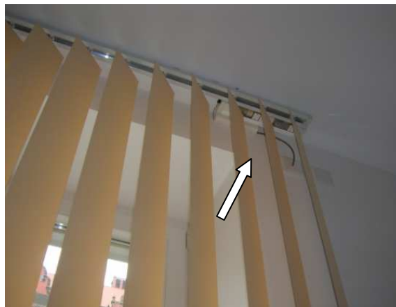
Rys. 6. Fotografia przedstawiająca zainstalowany, sterowany zdalnie, układ wykonawczy napędu żaluzji
