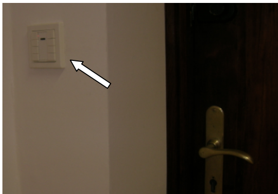
Rys. 5. Fotografia przedstawiająca zainstalowany przy drzwiach wejściowych łącznik czteroklawiszowy wielofunkcyjny z odbiornikiem podczerwieni
