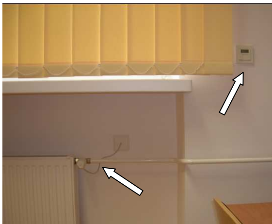
Rys. 4. Fotografia przedstawiająca zainstalowany elektrozawór i łącznik dwuklawiszowy z regulatorem temperatury
