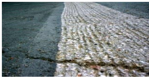
Rys. 5. Różnica w wyglądzie powierzchni betonowej przed i po frezowaniu [6]
