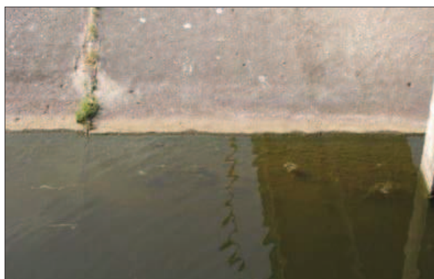
Fot. 2. Widoczne porastające mchy w połączeniach płyt betonowych
