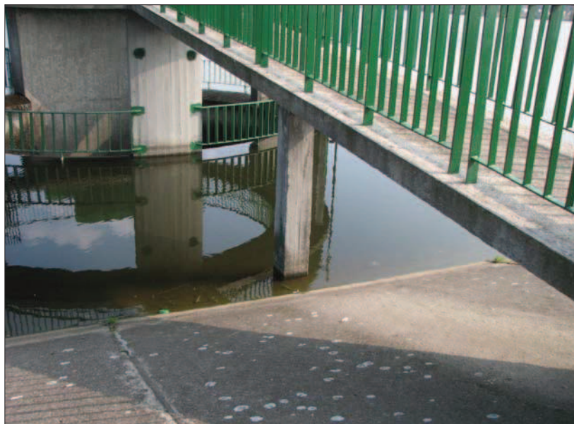
Fot. 4. Wieża upustowa i skarpa odwodna zbiornika Pokrzywnica – przybliżenie (widoczne miejsca ubytków betonu w następstwie procesu karbonatyzacji)
