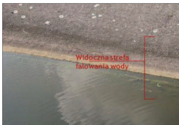
Fot. 1. Uszkodzona powierzchnia betonowa w strefie falowania wody
