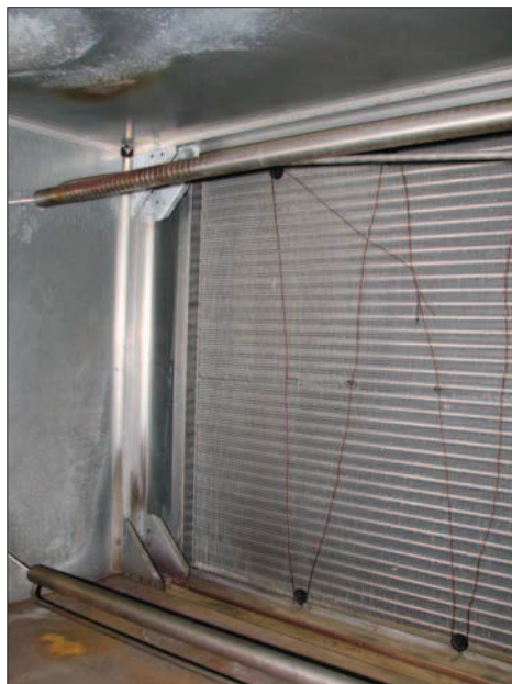
Fot. 3. Komora zraszania powietrza parą wodną
