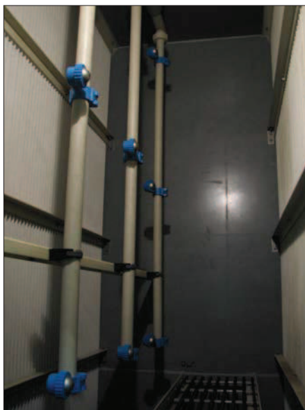
Fot. 2. Komora zraszania powietrza rozpyloną wodą
