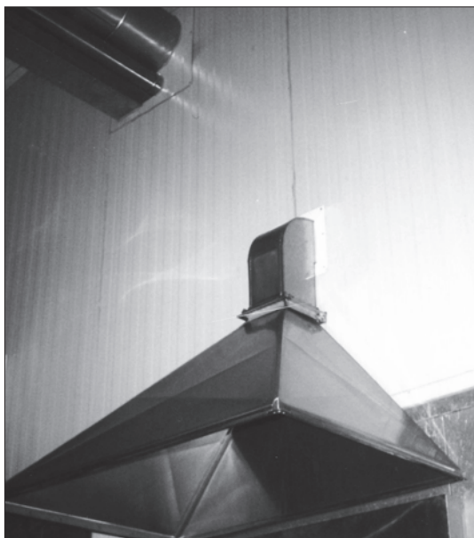
Fot. 3. Wentylacja lokalizacyjna – odciąg miejscowy w pomieszczeniu dozowania chemii do oczyszczania ścieków
