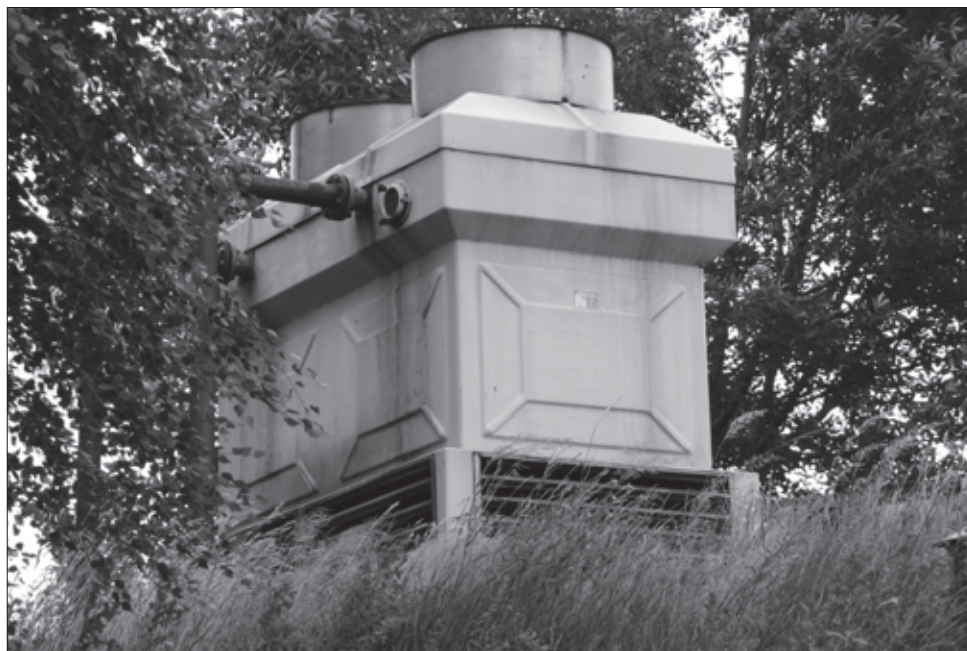
Fot. 7. Chłodnia wody technologicznej
