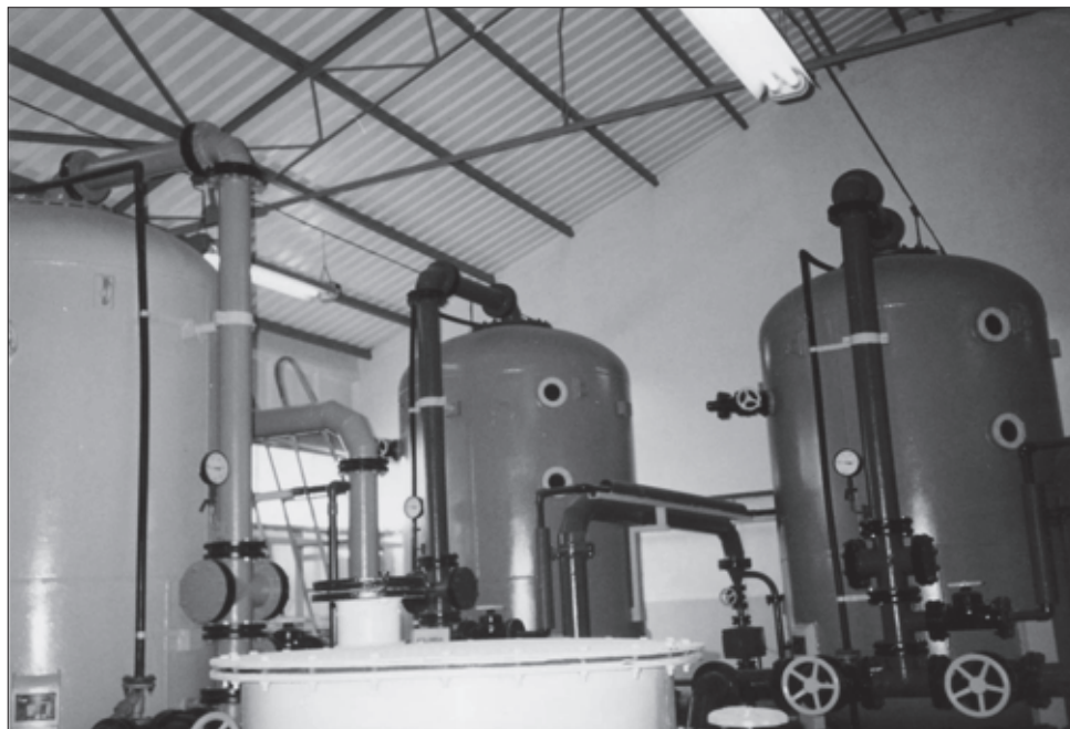
Fot. 8. Stacja uzdatniania wody w Kaliszu
