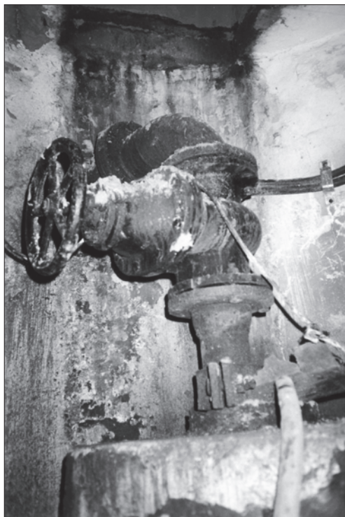
Fot. 1. Studnia ujęcia głębinowego – widoczna korozja metali i karbonatyzacja betonu
