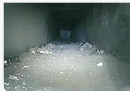
Fot. 2. Pył osiadły w kanałach wentylacyjnych Photo 2. Settled dust in ventilation ducts
