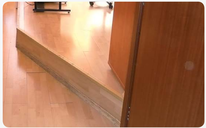
Fot. 1. Stopnie i występy w podłogach szkolnych są źródłem zagrożenia potknięciem i upadkiem Photo 1. Steps and thresholds in school floors are sources of trip and fall hazards
