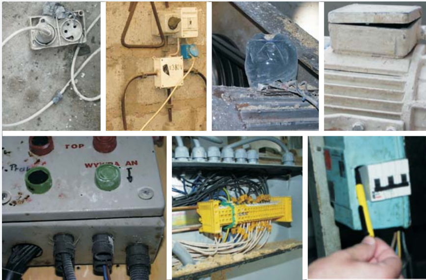
Fot. 4. Przykłady uszkodzenia obudowy wyposażenia elektrycznego (niezachowany stopień ochrony wynikający z wymagań dla określonych kodów IP)
