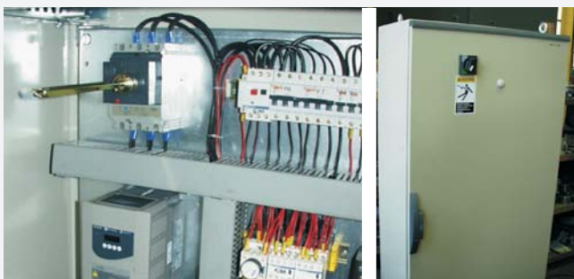
Fot. 7. Przykład obudowy – otwarcie możliwe po odłączeniu części czynnych znajdujących się wewnątrz
