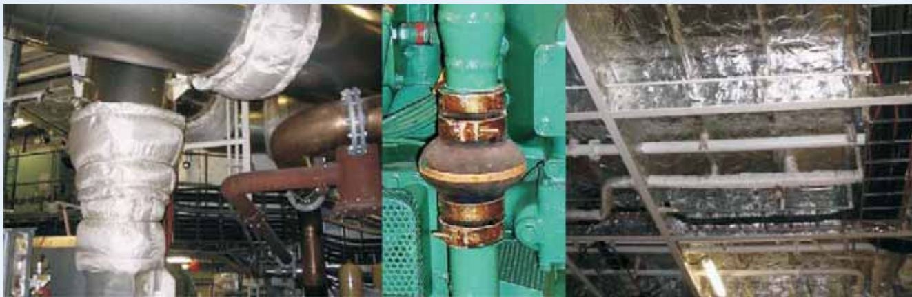
Fot. 2. Przykłady izolacji akustycznej i redukcji drgań w maszynowni okrętowej Photo 2. Examples of noise insulation and vibration reduction in a marine engine room
