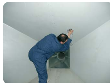
Fot. 2. Pozycja ciała oznaczona jako B przyjmowana podczas czyszczenia ściany górnej kanału wentylacyjnego Photo 2. Body posture B when duct cleaning
