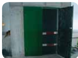
Fot. 12. Zabezpieczenie poprzeczne wejścia do szybu windowego
