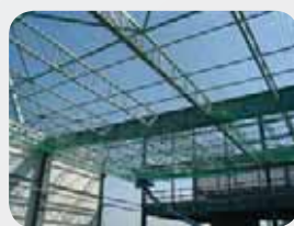
Fot. 9. Siatki bezpieczeństwa w układzie „S”
