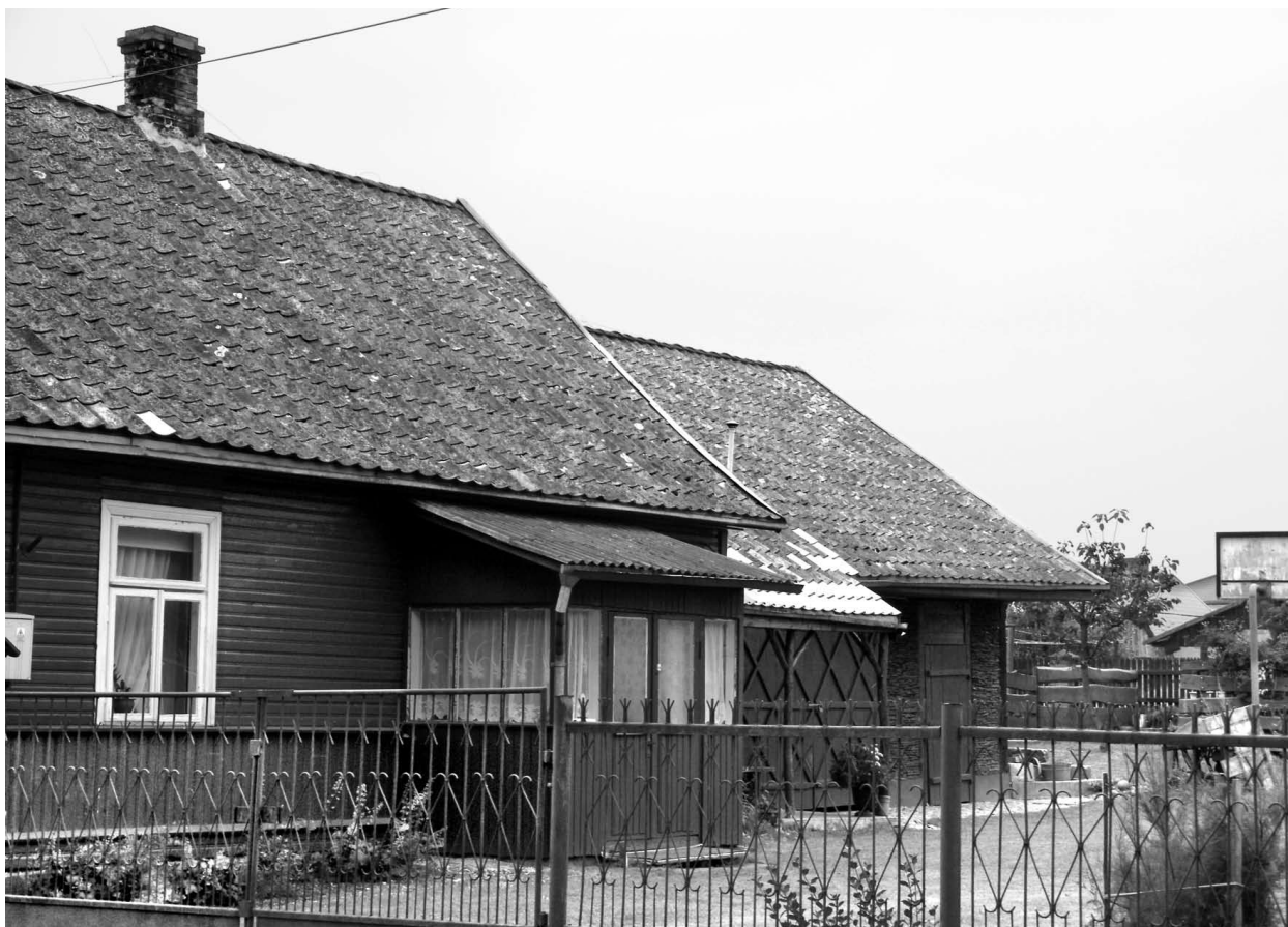
Ryc. 10. Dom przy ul. ks. E. Szapela nr 20 w Czarnej Wsi Kościelnej – dobudówka z tyłu ma ściany z dachówkowych skorup spajanych gliną. Fot. Jarosław Szewczyk, 2012
