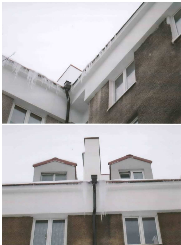
Rys. 3. Oblodzenia i sople lodowe w obszarze okapu. Na ścianach są plamy po zaciekach. Największa długość sopli wynosi około 150 cm
