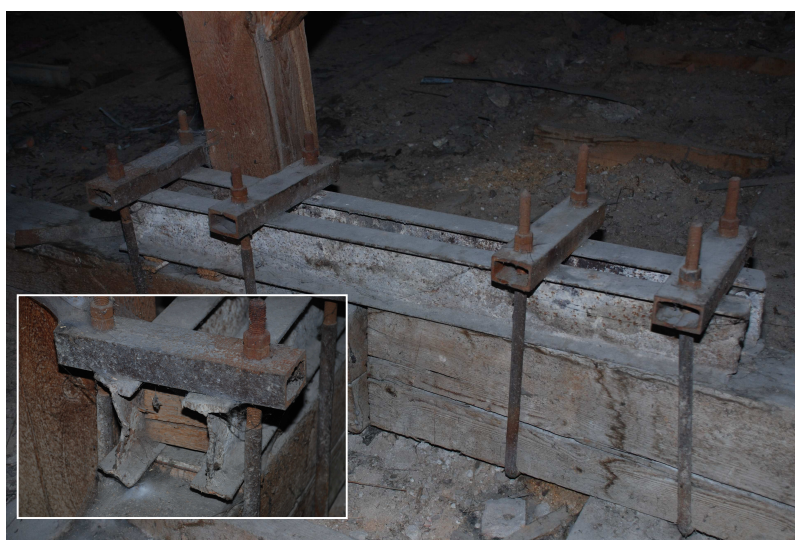
Rys. 5. Wady stalowej konstrukcji wzmocniającej połączenie belek drewnianych
