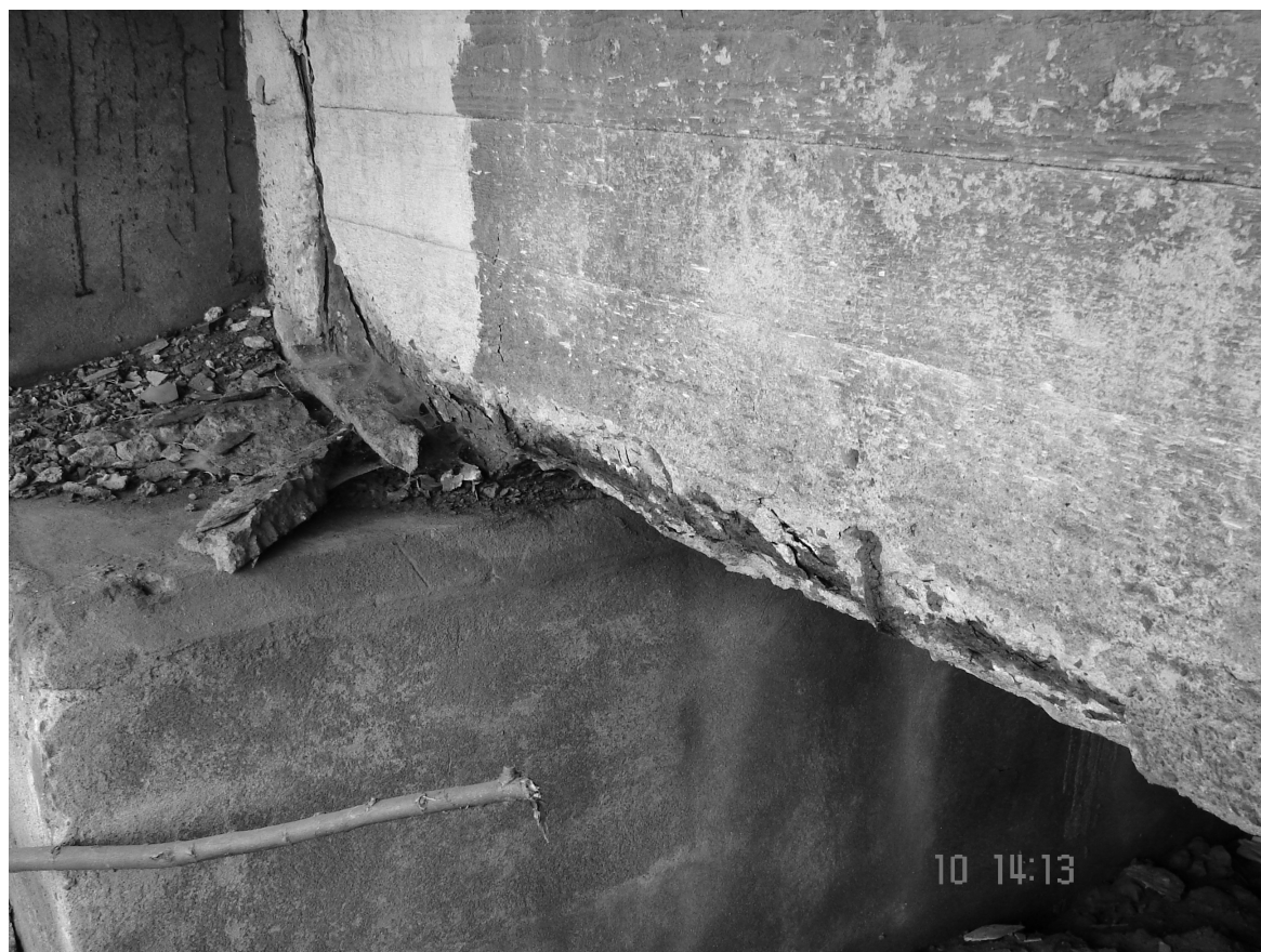
Rys. 5. Most w Jaktorowie w ciągu drogi wojewódzkiej Nr 719 Grodzisk Mazowiecki-Żyrardów – widoczna korozja zbrojenia na skutek nieszczelnej izolacji
