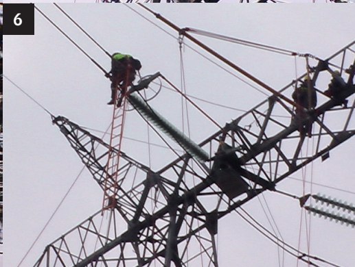
Fot. 5. PPN na linii 400 kV, zawieszenie ŁO2-400 – wypięcie łańcucha izolatorowego
