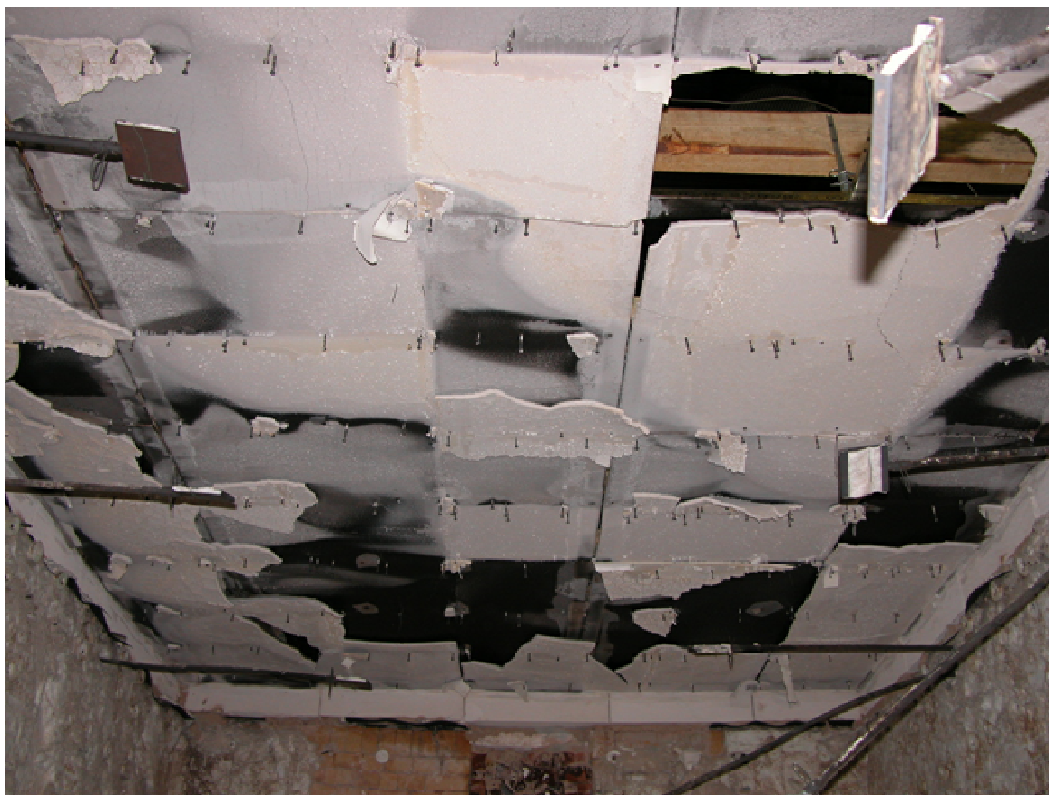
Rys. 4. Widok sufitu podwieszonoego od strony nagrzewanej po badaniu
