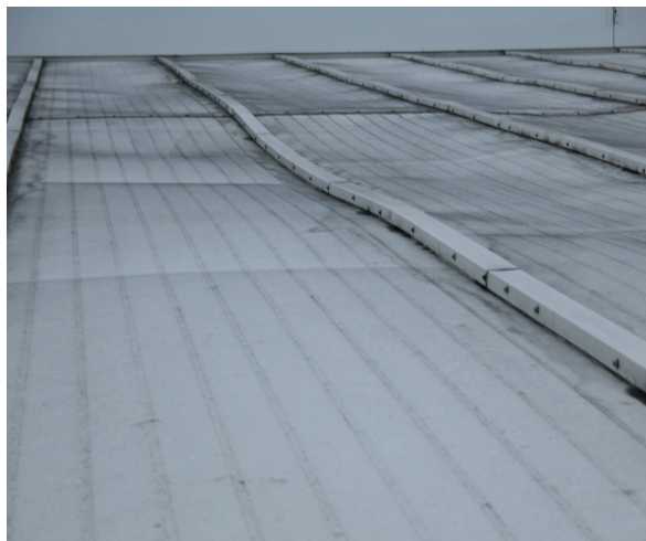
Rys. 4. Widok odkształconej połaci dachowej
