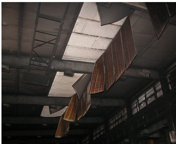
Rys. 3. Uszkodzenia wewnętrznej powierzchni płyt warstwowych.
