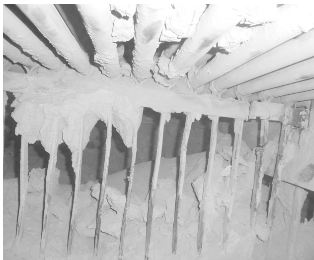
Rys. 2. Spieczone osady popiołowe na powierzchni wymiany ciepła w kotle
