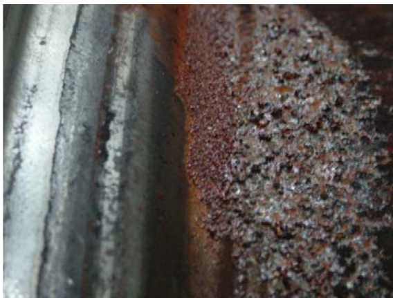
Rys. 4. Ogniska korozyjne w przetłoczeniu obręczy. Na podstawie cech charakterystycznych zakwalifikowano ją jako korozję tlenkową
