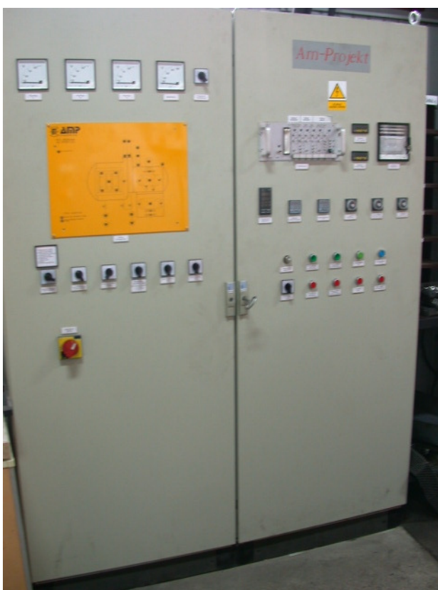
Rys. 2. Szafa sterownicza zmodernizowanego pieca RVFOQ-224 w hartowni Pracowni Obróbki Ciepłej Instytutu
