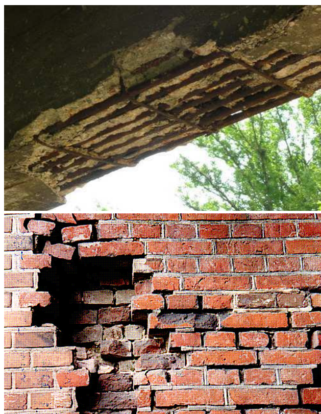
Rys. 3. Ubytki materiału konstrukcyjnego (Bień, 2009)
