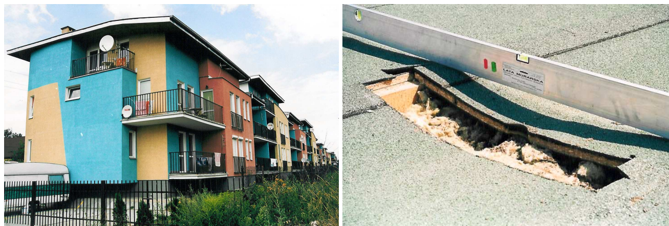
Rys. 4. Nadmierna deformacja drewnopochodnych elementów stropodachu niewentylowanego
