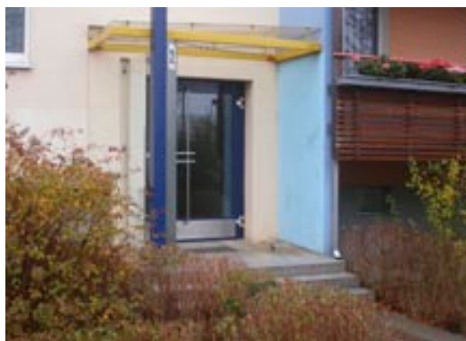
Ryc. 5. Fotografia przedstawia przeprowadzone już prace budowlane związane z nowym ukształtowaniem wejścia do klatki schodowej budynku przy Stendalerstrasse na osiedlu Hellersdorf w Berlinie, fot. autor
