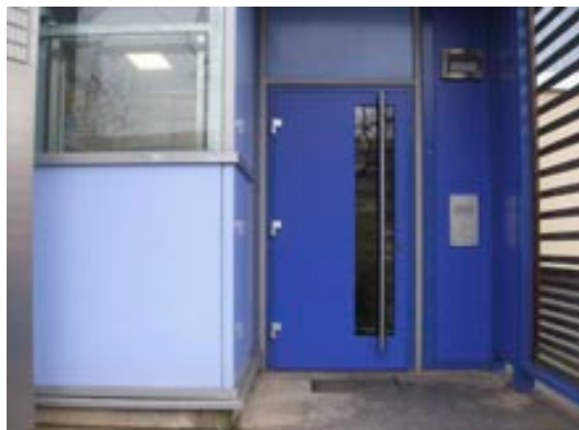
Ryc. 4. Przykład zainstalowanej nowej stolarki drzwiowej. Uwagę zwraca bardzo wysoki standard instalowanych drzwi wejściowych do klatek schodowych zmodernizowanego budynku przy Stendalerstrasse w dzielnicy Hellersdorf w Berlinie, fot. autor
