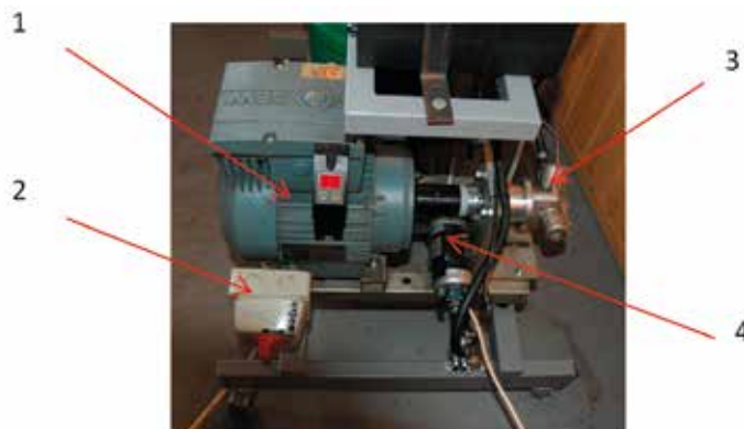
Rys. 5. Zespół napędowy pompy wysokiego ciśnienia
