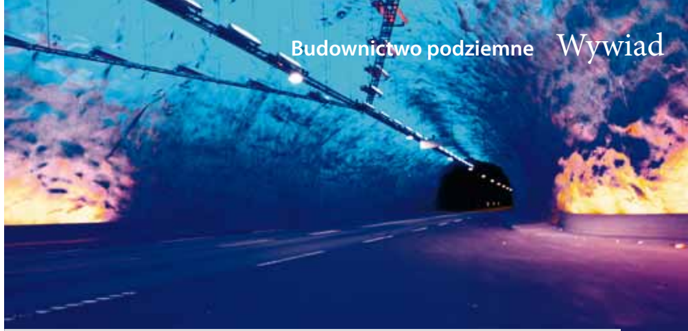
Tunel Laerdal (Norwegia, 26 km) – oświetlenie komór bezpieczeństwa, fot. A. Siemińska-Lewandowska
