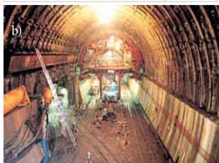
Ryc. 5. Technologia drążenia tunelu Seikan: a) schemat obrazujący technologię wykonania tunelu (opracowanie własne), b) widok przodka tunelu [13]: 1 – wyrobiska spągowo-ociosowe wyprzedzające, 2 – obudowa stalowa tymczasowa wyrobisk spągowo-ociosowych, 3 – przyspągowa obudowa ostateczna ociosów, 4 – wyrobisko kaloty, 5 – stalowo-kotwowa obudowa wstępna kaloty, 6 – szyny jezdne pod deskowanie przesuwno, 7 – rama deskowania przesuwnego, 8 – obudowa ostateczna kaloty, 9 – obudowa spągu
