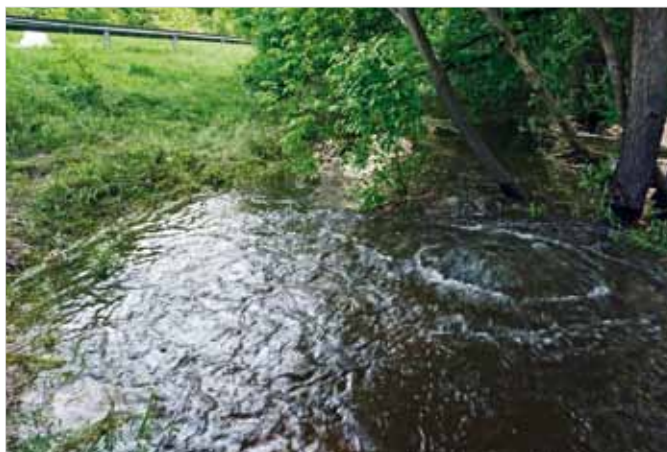
Ryc. 2. Wylot przepustu z ryciny 1. Widoczny syfon wynikający z niedostatecznej średnicy przepustu, fot. A. Wysokowski
