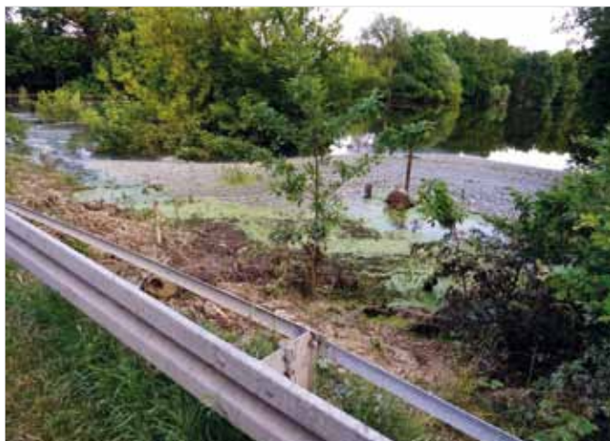
Ryc. 1. Zatopiony wlot przepustu w ciągu drogi wojewódzkiej, fot. A. Wysokowski
