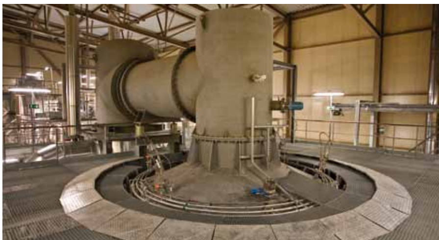
Stacja Termicznej Utylizacji Osadów – piec
