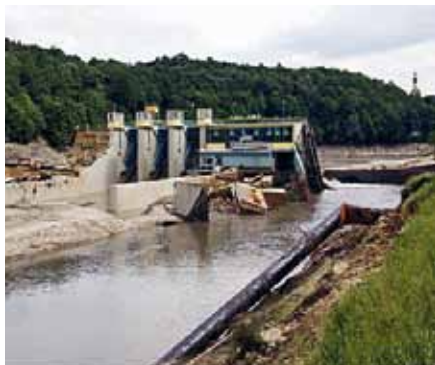
Ryc. 1. Katastrofa budowlana zapory Niedów na rzece Witka spowodowana przez nawalny opad w niewielkiej zlewni zbiornika, związany z tym gwałtowny przybór wód i przelanie się wody przez zapórę, 7 sierpnia 2010 r., źródło: internet, za [1]
