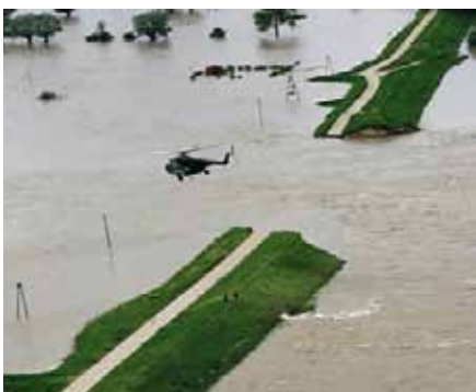
Ryc. 2. Przerwany wał przeciwpowodziowy, 2010 r. Oprócz całkowitego zniszczenia fragmentu wału nic nie przesądza o kwalifikacji zdarzenia. To niekiedy nie była katastrofa budowlana, źródło: internet, za [1]
