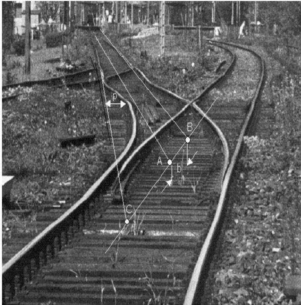
Rys. 4. Zniekształcenie układu spowodowane brakiem przesunięcia styku przedglicowego rozjazdu 300-1:9 w stosunku do poprzedniego rozjazdu 190-1:9 [fot. H. Bałuch]
