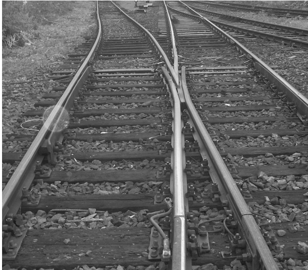
Rys. 13. Rozjazd łukowy dwustronny z wymienioną prostą krzyżownicą; zauważalny załom za prawą szyną dzioba krzyżownicy [fot. D. Drozd]
