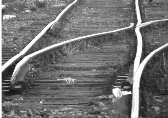
Rys. 17. Błędy w montażu rozjazdu; wygięta szyna łącząca i załom za krzyżownicą [fot. J. Płusa]
