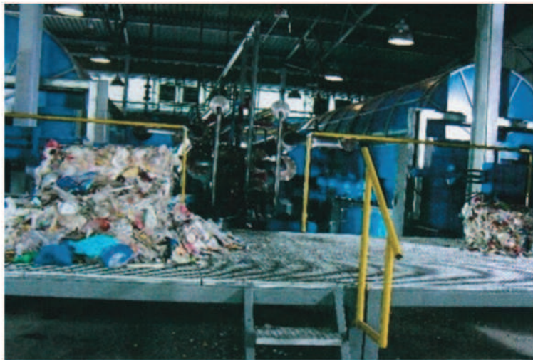
Fot. 2. Instalacja wytwarzania paliw płynnych na drodze transformacji termokatalitycznej posiadana przez firmę Akropos
