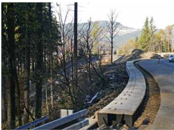
Osuwisko nr 1. Widok górnej bariery mikropalowej
