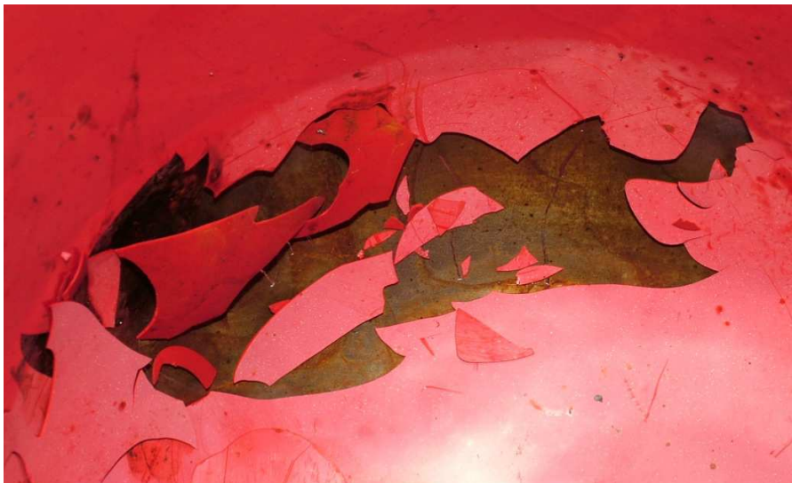
Ryc. 6. Zbiornik z wadliwie naniesioną powłoką malarską. Widoczne znaczne zniszczenie korozyjne zbiornika.
