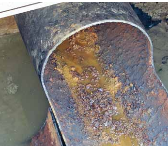
Rurociąg przed czyszczeniem
