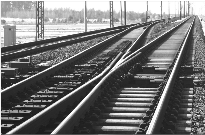
Rys. 1. Krzyżownica z ruchomym dziobem w rozjeździe zwyczajnym nr 40 na stacji Psary
