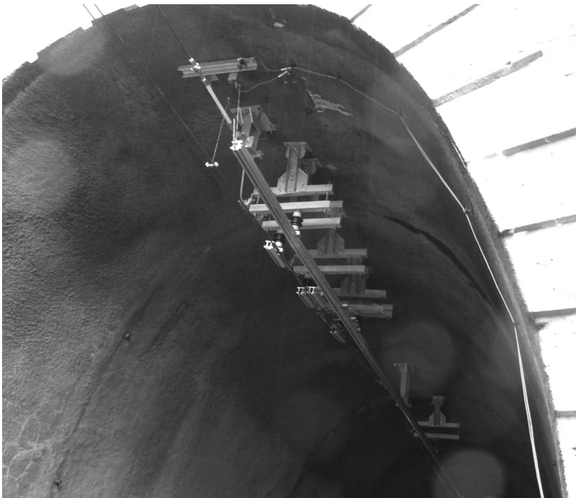
Rys. 11. Górna sztywna sieć trakcyjna koło stacji Tunel (fot. M. Kaniewski)
