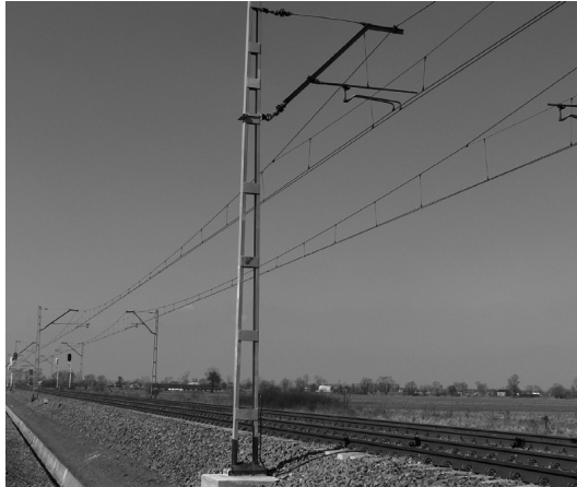
Rys. 1. Sieć trakcyjna typu YwsC120-2C na linii E20, szlak Kutno – Żychlin (fot. K. Zasadziński)
