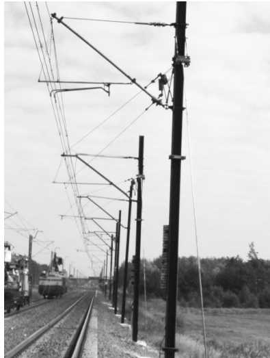
Rys. 7. Sieć 2C120-2C, sześciostłupowe przęsło naprężenia 5×21 m (fot. M. Kaniewski)
